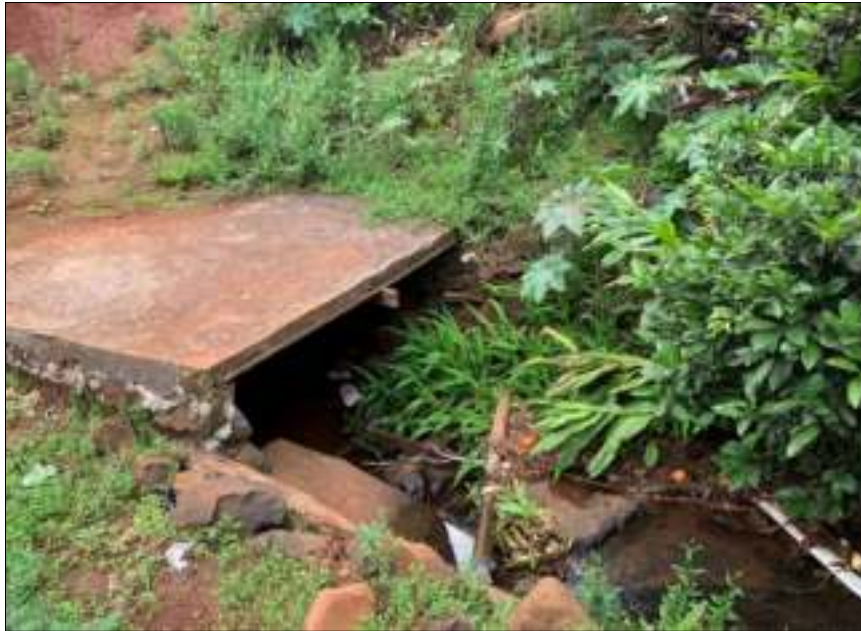
Figura 114 – Obstrução de Estruturas de Microdrenagem.
