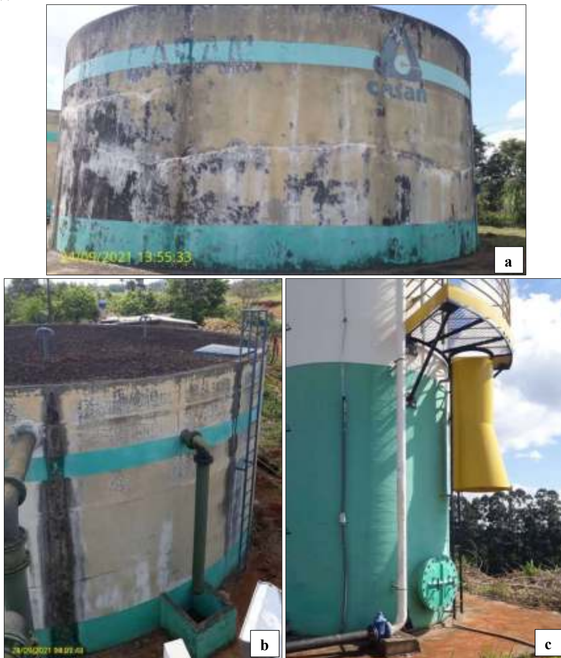
Figura 88 – Reservatórios de água do município de Palmitos: (a) Reservatório R1; (b) Reservatório R2; (c) Reservatório R4;
