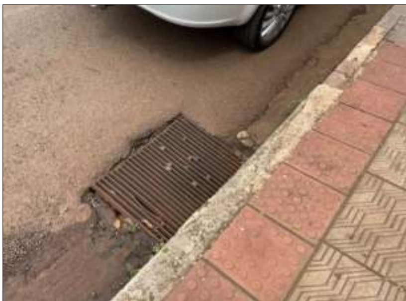
Figura 83 – Sistema de microdrenagem (bocas de lobo) encontradas no município.
