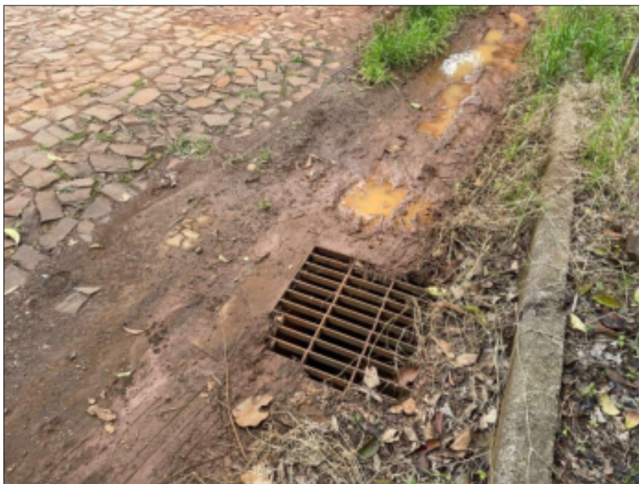
Figura 84 – Exemplo de bocas de lobo com obstruções que dificultam o escoamento superficial das águas pluviais.
