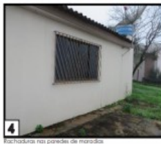
4 Rachadura nas paredes de moradia.
