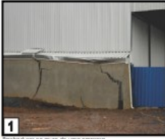
1 Rachadura no muro de uma empresa.
