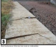
3 Rachadura e fendas na rua e calçada.
