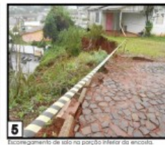
5 Encrocamento de solo no parção inferior da encosta.
